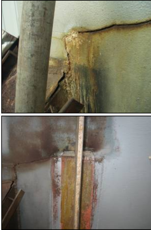
Slika 1. Prslina na otvoru dimovodnog kanala sa leve strane u odnosu na penjalice (na desnoj strani otvora)
