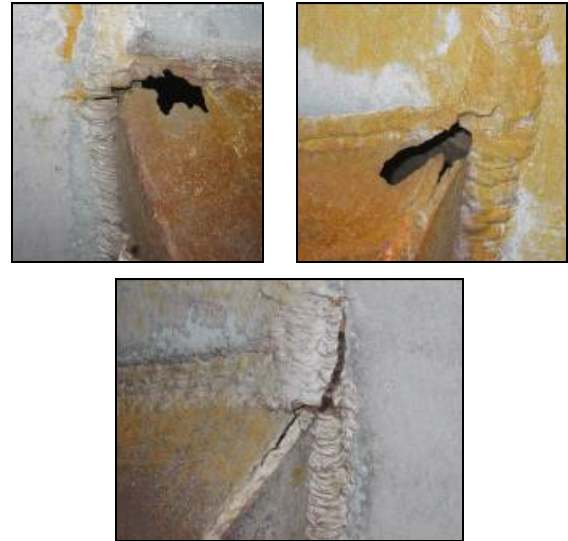
Slike 3 i 4. Inicijalne prsline na otvorima dimovodnih kanala otkrivene nakon peskarenja plašta dimnjaka
