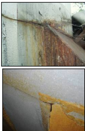
Slika 2. Prslina na otvoru dimovodnog kanala sa desne strane u odnosu na penjalice (na levoj strani otvora)
